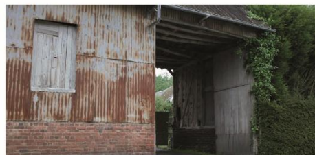
Englebermer : la réparation de fortune des granges en torchis par du bardage métallique nuit à l'image rurale du village
