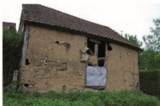
Raincheval: ossature apparaissant sous le torchis
