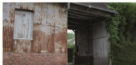
Englebeimer : la réparation de fortune des granges en torchis par du bardage métallique nuit à l'image rurale du village
